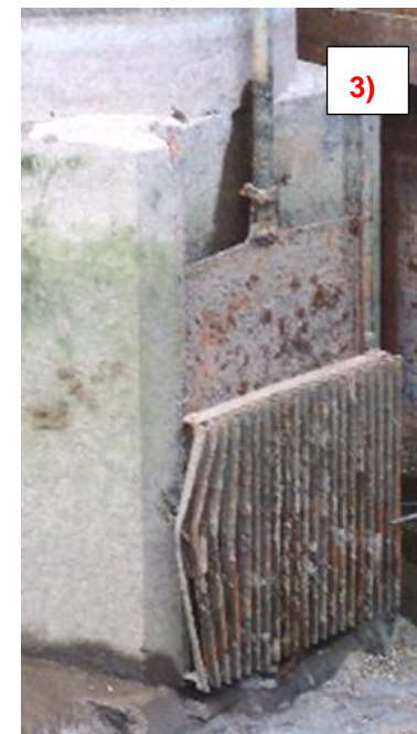
Figure 17 : Vanne et grille d'admission à remplacer.
