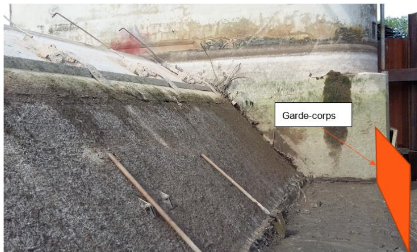
Figure 27 : Dispositif de garde-corps à l'amont des vannes toits.
